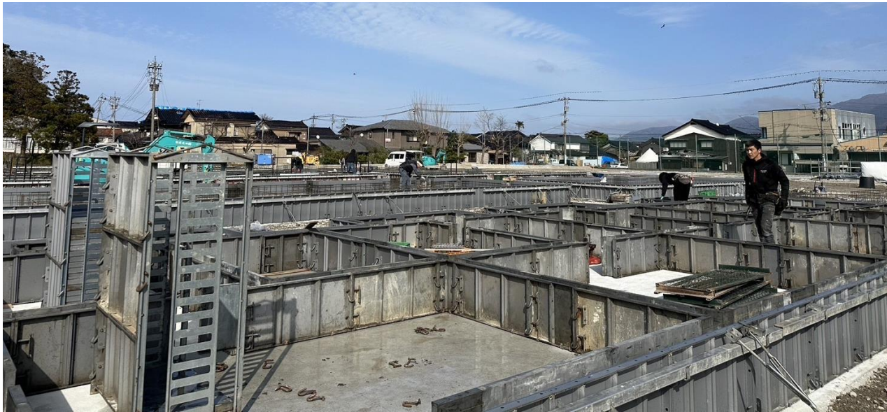
4月1日から大工工事予定の鳳至小学校の基礎工事の様子(3月24日時点)
