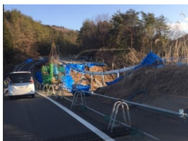
のと里山街道は片側車線が陥落し片側通行に(能登方面のみ通行可)
