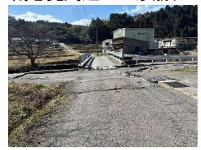
道路が陥没(南志見グラウンドそば)
