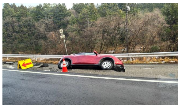
潰れてしまった住宅(写真上)、道路の片側が陥没し横転した車が現在もそのままに(写真下)
